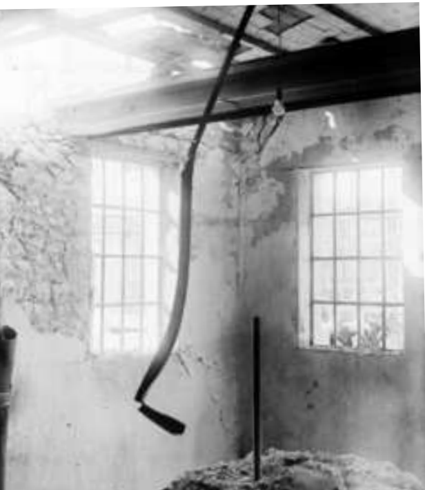
Instal·lacions de la central elèctrica de Talarn després del bombardeig // PROCEDÈNCIA: Fons Pompeu Molist.
