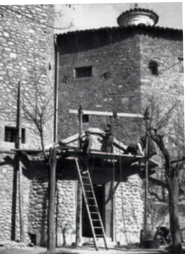
Construcció de la torre escala i vestibul d'accés a l'arxiu del museu. El que puja per l'escala és Jaume Sadurní Nunó; a l'obra hi varen treballar dos paletes, els germans Formatger, que treballaven per l'Ajuntament de Ripoll. Any 1929 // PROCEDÈNCIA: Arxiu Comarcal del Ripollès.
